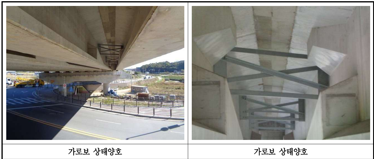
【사진 33.3.7】 가로보 손상현황
