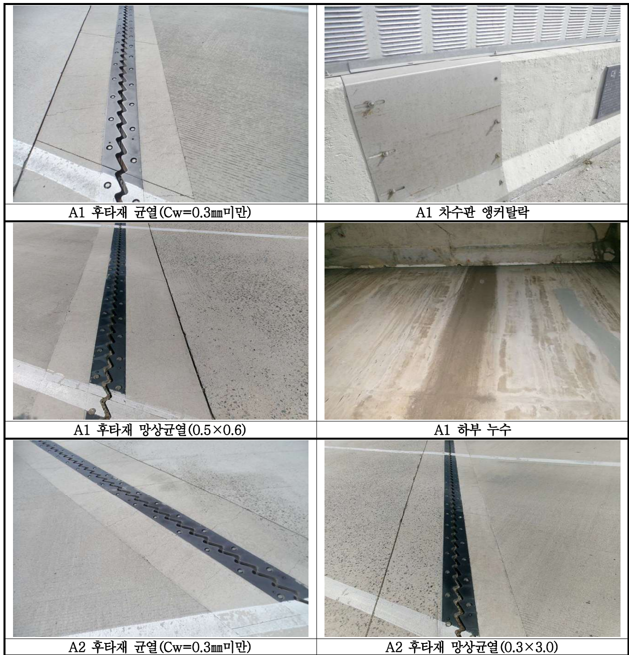
【사진 33.3.17】 신축이음장치 손상현황
