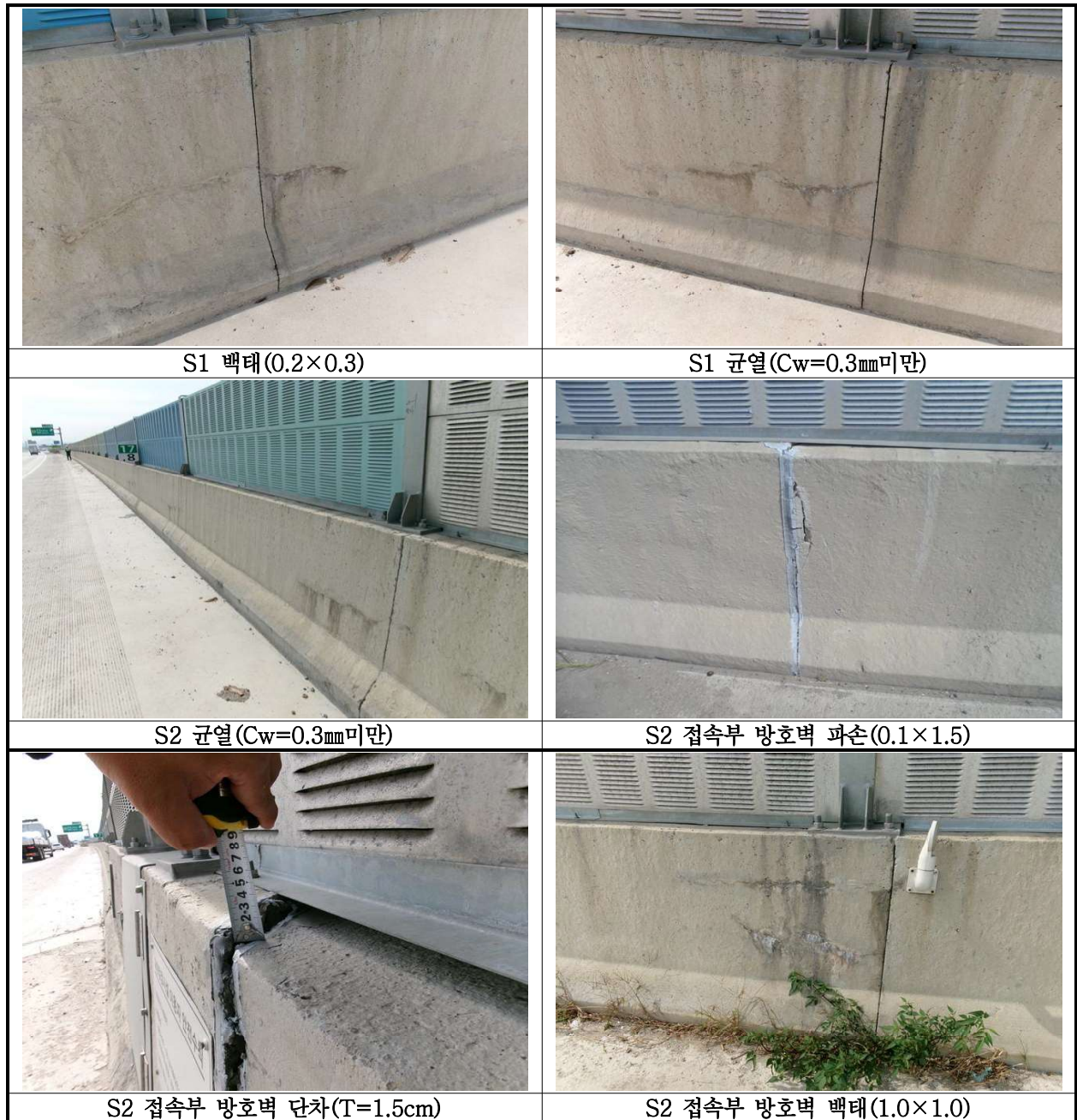
【사진 33.3.24】 방호벽 및 중앙분리대 손상현황
